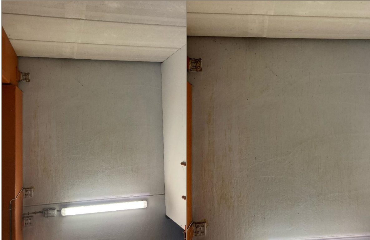
Figur 3. Foto inifrån panncentralen där man ser spår av fladdermöss i form av spillning (urin och avföring) som runnit ned för väggen. Spillning hade ansamlats ovanpå belysningskablar under denna yta, varifrån den samlades in och skickades för eDNA-analys och artbestämning.
